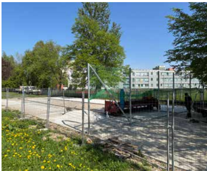
V ulici Jana Maluchy na Dubině se blíží k dokončení Indiánské hřiště. Asfaltová část plochy bude určena k míčovým hrám, v oblouku s umělým povrchem vznikne hřiště na workoutové cvičení.
